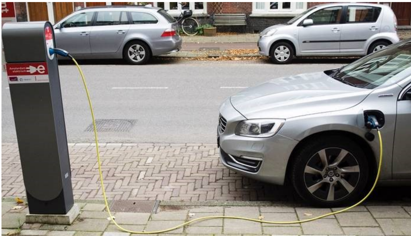
Een auto tapt stroom van het net in Amsterdam..... | Foto: HH
